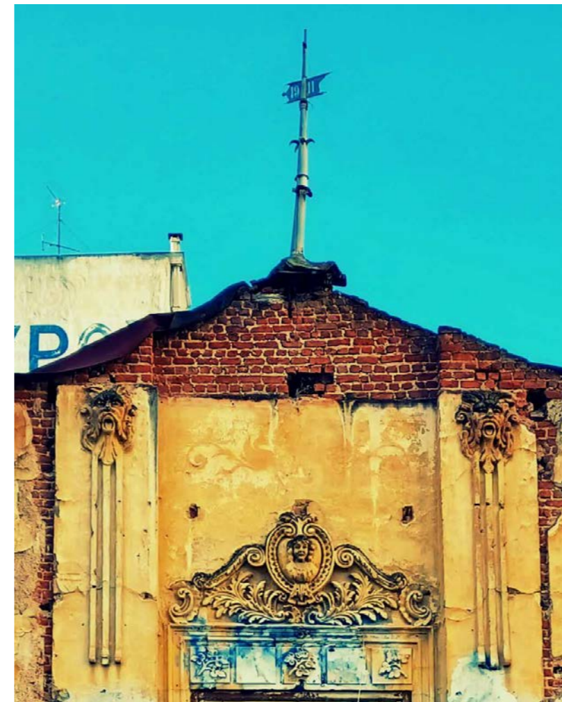
7 | Detail van de gevel van de bouwvallige villa van Vitali Fernandez-Hirsch
